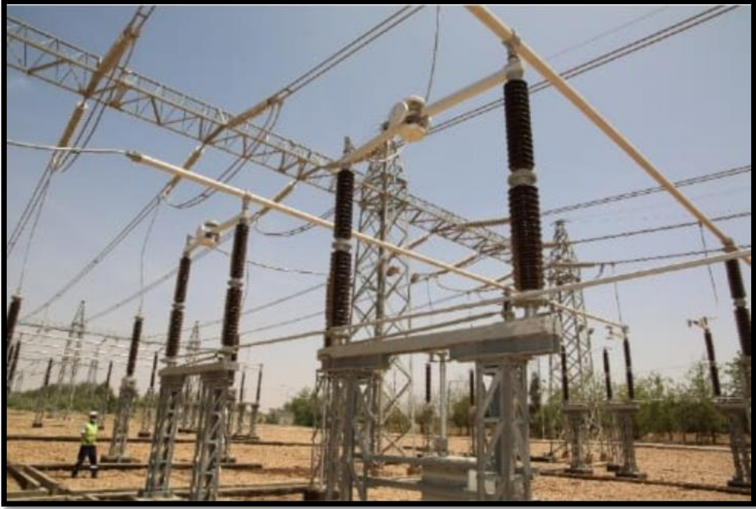
(أ) محطة كهرباء مدينة ابو حمد
